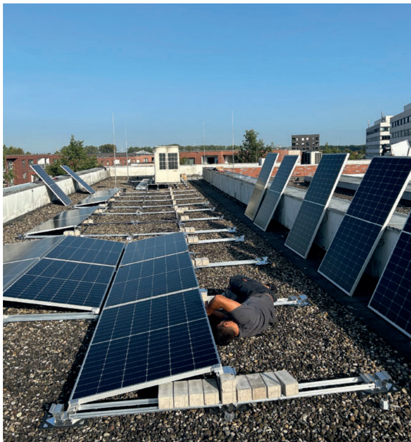
Auf dem Dach des Ärztehauses wurde im vergangenen Herbst eine Photovoltaik-Anlage installiert. Sie soll vor allem die Server der Ärztekammer-IT mit der nötigen Energie versorgen. Foto: Peter Brockkötter
